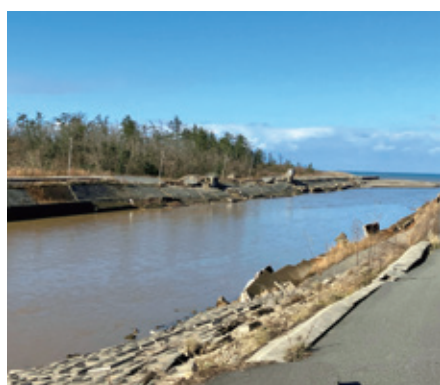
震災直後、両岸が大きく崩れている河川の様子
